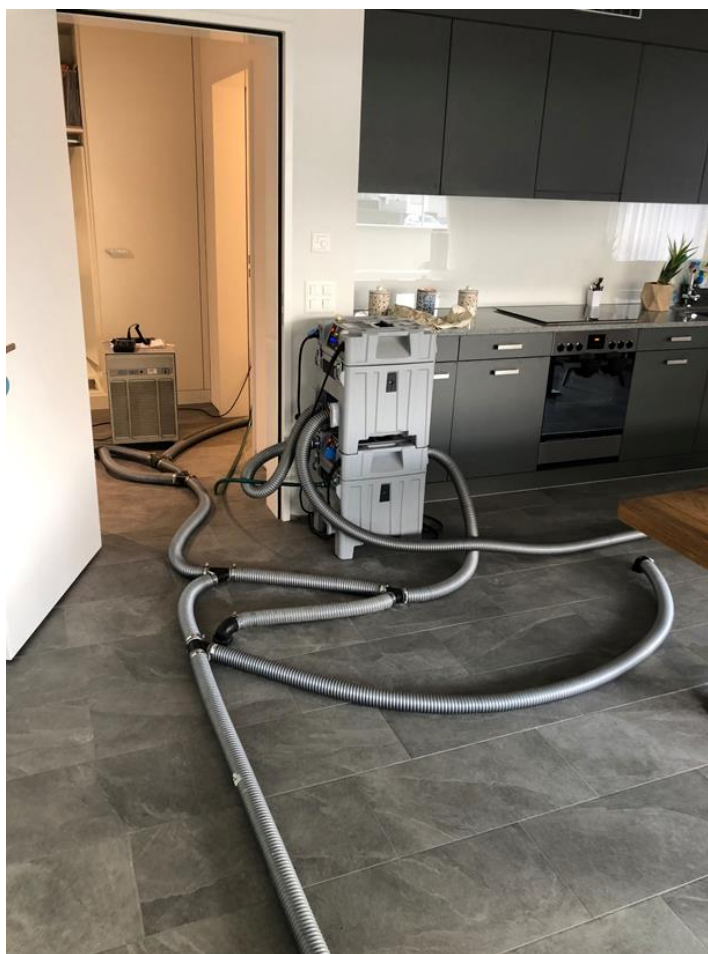
"Rohrgewirr" bei der Austrocknung der Wohnung Siedlung Luegisland Nord, die bei einem Kanalisationsrückstau überschwemmt wurde.
